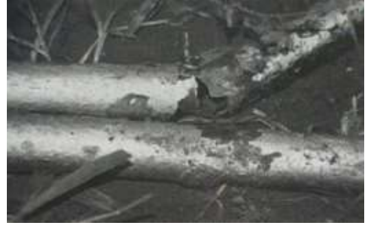
Foto mostra ferrugem na estrutura do camarote que desabou em Franca, SP — Foto: Polícia Civil/Divulgação
