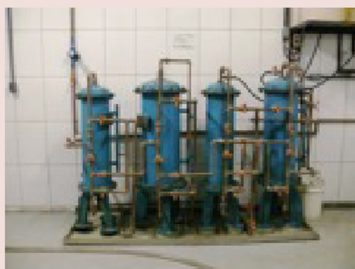
Figura 10 – Trocador iônico com resinas para polimento da água de reuso em circuito fechado
