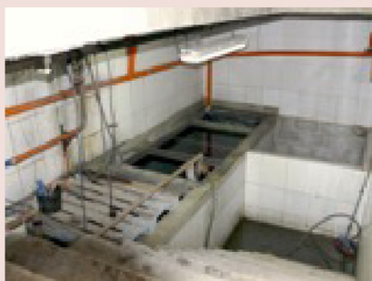
Figura 5 - “Vista A”- reservatório enterrado para armazenagem temporária dos resíduos líquidos
