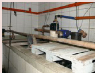
Figura 6 - “Vista B”- reservatório enterrado para armazenagem temporária dos resíduos líquidos
