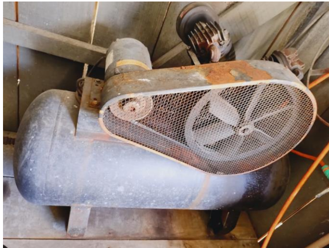
Figura 23 - Compressor de ar
