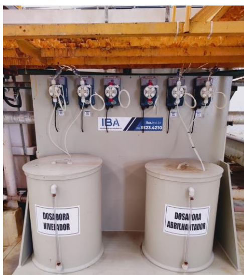
Figura 11 - Bombas dosadoras de níquel
