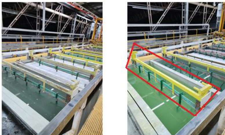
Figura 3 - Barramentos de cobre
