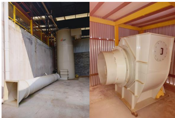
Figura 16 - Lavador de gases desmontado
