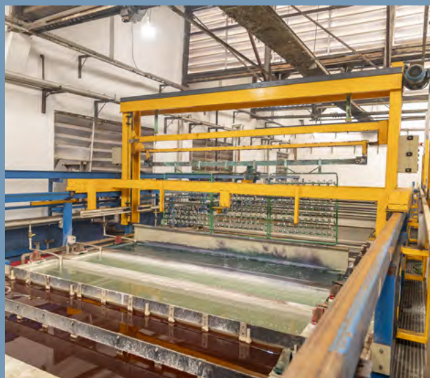
Linha automática de eletrodeposição de zinco
